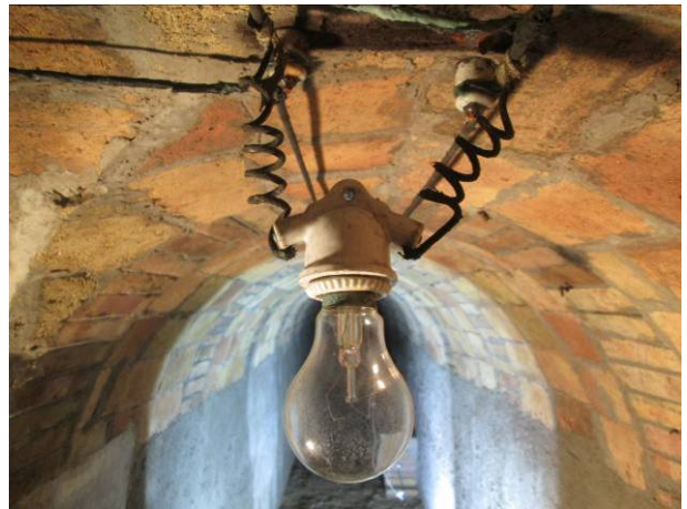
22. Punt d'il·luminació a la cruïlla entre els Trams 3 i 4
