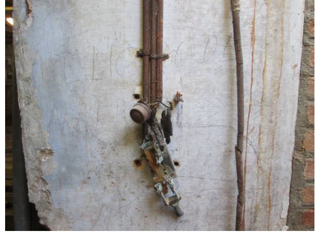
2. Interruptor per connectar la llum a l'interior del refugi
