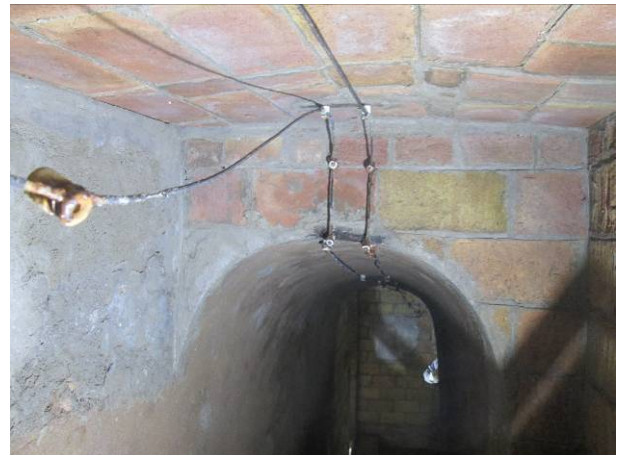
6. Instal·lació elèctrica al Tram 2
