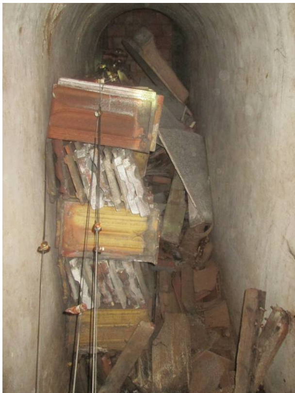
107. Teules apilades i cablejat elèctric
